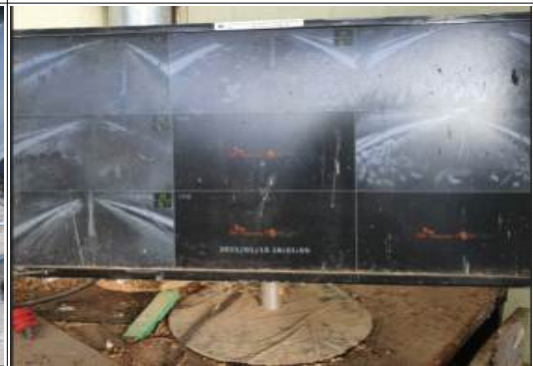
CCTV 고장 방치
